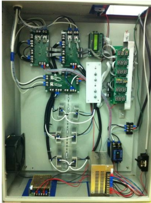
รูปที่ ๓. ระบบป้องกันเพลิงต้นแบบจากงานวิจัย
